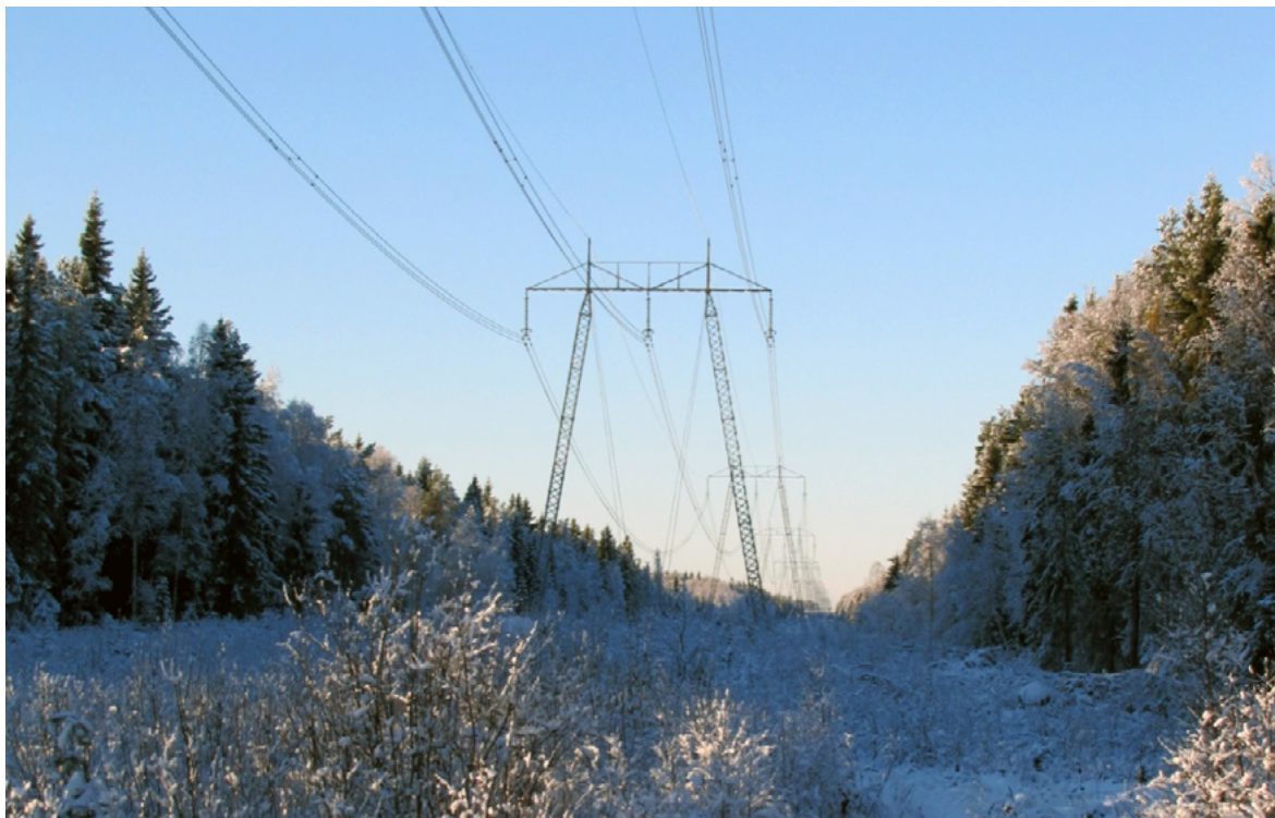
Luftledning för 400 kV.
