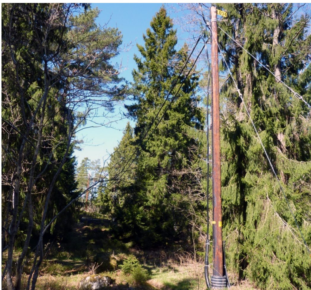
Luftledning med hängkabel, 10 kV.
