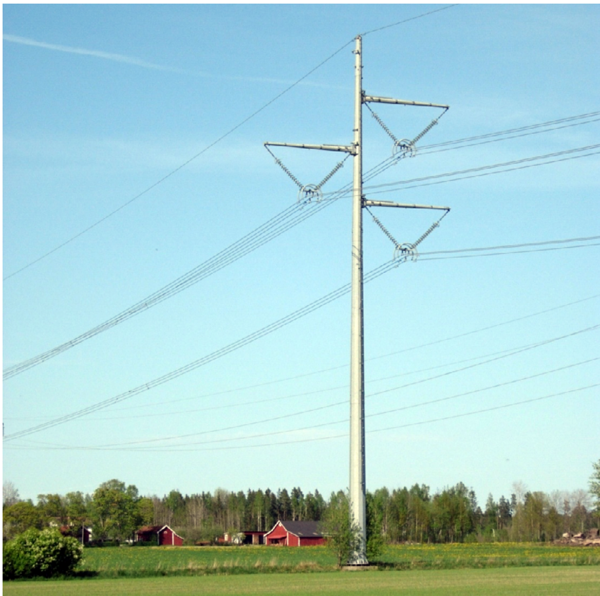
Bild 9. Kompaktstolpe för 400 kV med fasledarna i triangelform.
