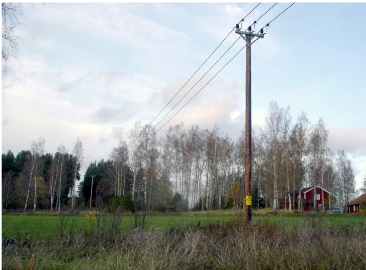
Luftledning med isolerade (plastbelagda ledare, BLL), 10 kV.
