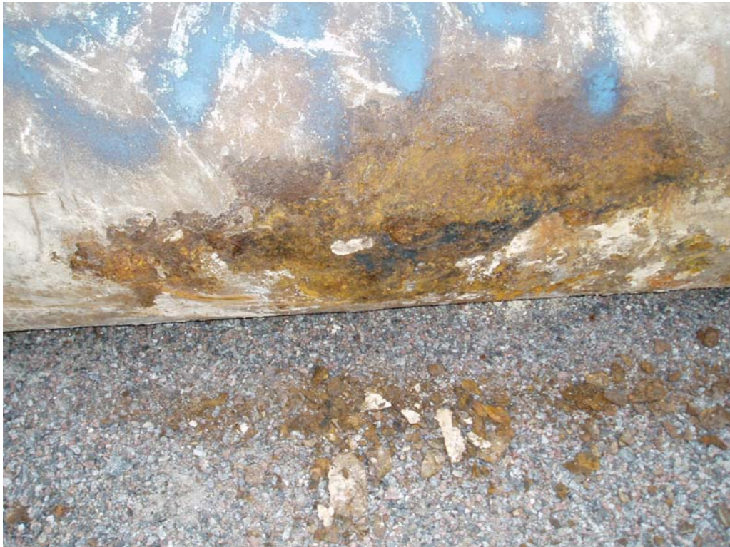
Bild 17 Kraftig korrosionsskada på framledning från Rinkeby, Stockholm.
