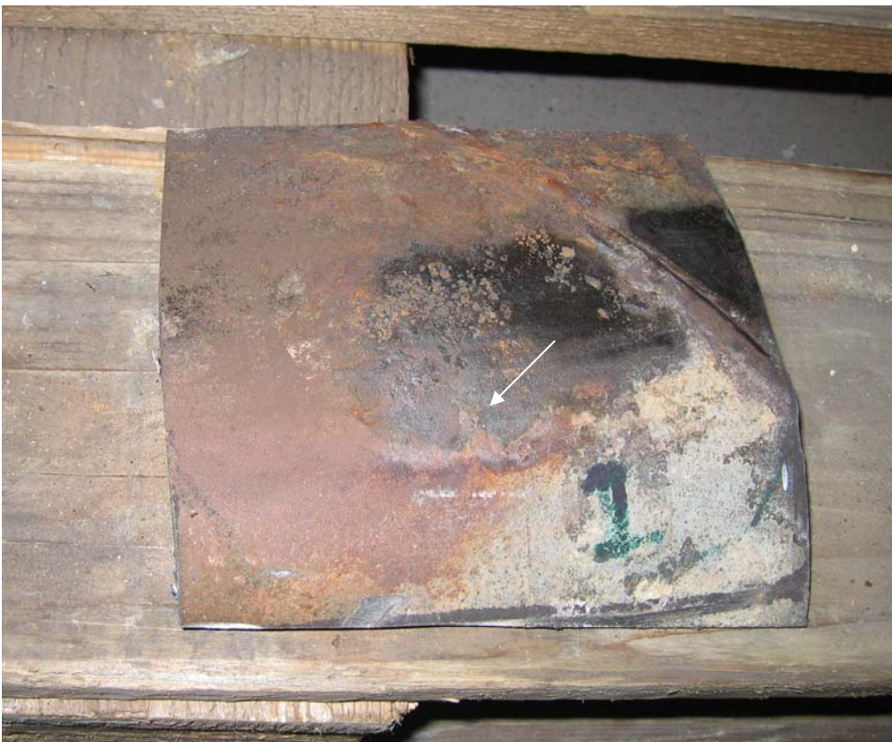
Bild 13a Bild 13a Mät punkt nr 1. Vid slipning av rostbeläggning framträdde ett stort antal frätgropar, se markering med pil.
