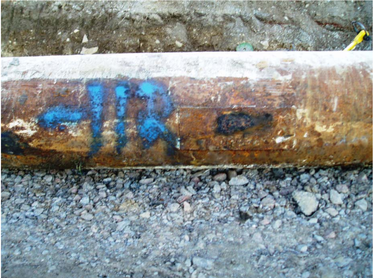
Bild 18 Korrosionsskada i stödplåt på returledning i riktning bakåt, nedåt backe.
