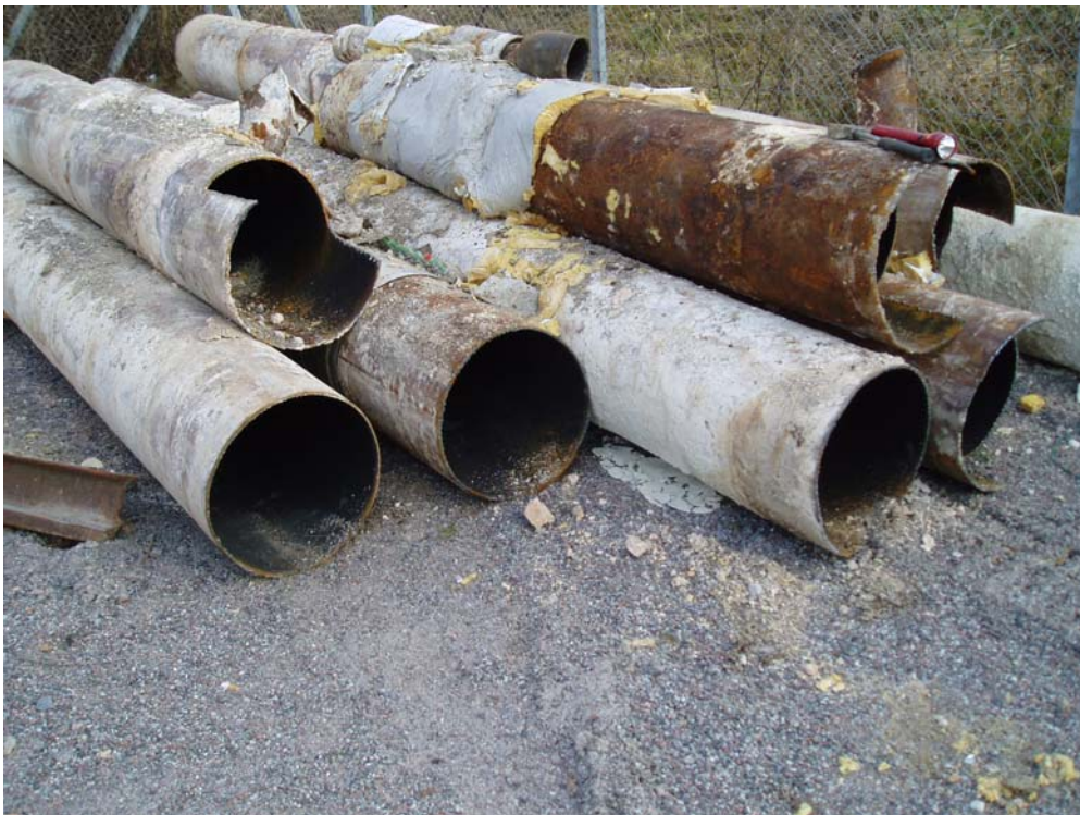
Bild 16 Frilagd framledning från Rinkeby, Stockholm. Rören är i dålig kondition och djupare korrosionsangrepp förekommer i flera områden på rören.
