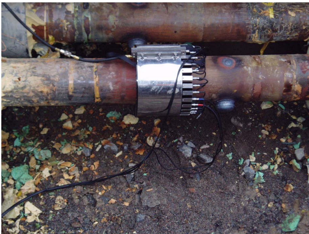
Bild 3 Teletestverktyg monterat på fjärrvärmerör
