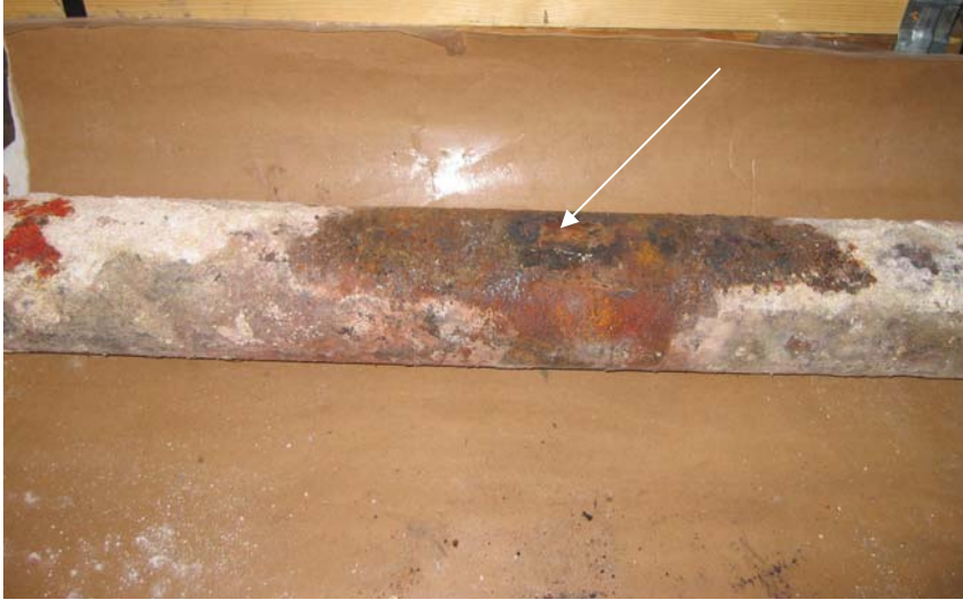
Bild 26 Utkapad rörbit som innehåller läckan, vilken är markerad med pil. Hela röret är angripet av kraftig korrosion.
