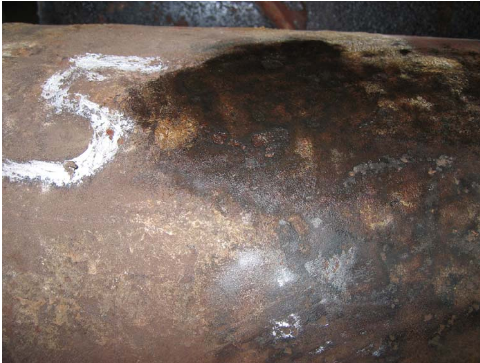
Bild 13b Mätpunkt nr 5. Mindre frätgropar framträdde efter att rostskiktet hade slipats bort.
